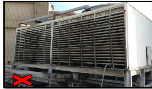
維護冷卻水塔之散熱效率
